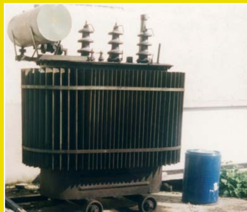
Transformator, sadrži ulje (A1180)
